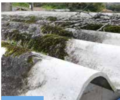
Fibrocemento deteriorado. Material friable.
