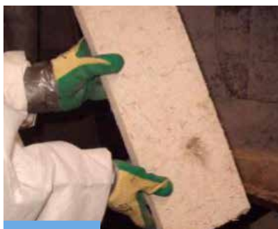
Ladrillo de amianto. Material muy friable.
