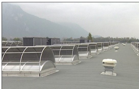
Exemple de protections solaires par l'extérieur en toiture avec groupes de rafraîchissement d'air (caissons noirs).
