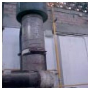
Tuberías con amianto confinadas .
