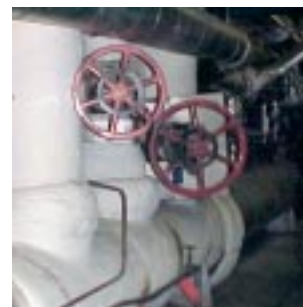
Tuberías con amianto estabilizadas
