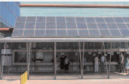
Instalación solar fotovoltaica en taquillas del centro ferial IFEMA.
