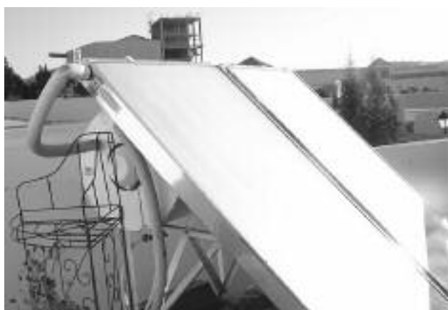
Instalación de agua caliente solar
