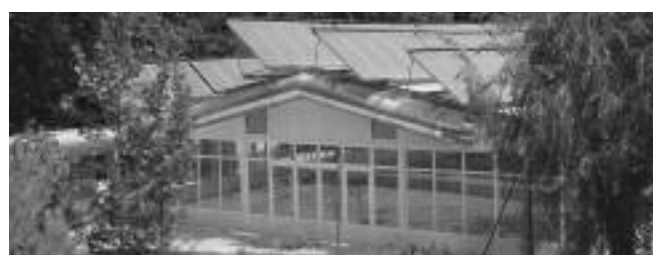
Instalación de energía solar térmica
