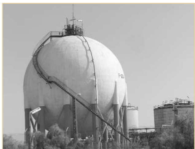
Tanque de refinería. Este tipo de instalaciones requiere un Plan de Emergencia Interior.
